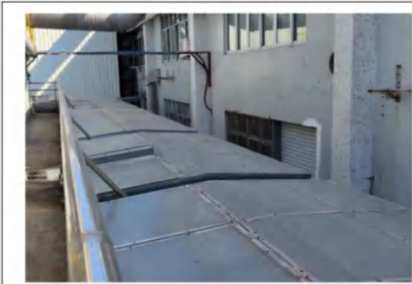
污水处理站密闭收集措施
