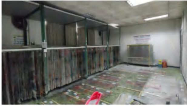
贴板房密闭正压收集
